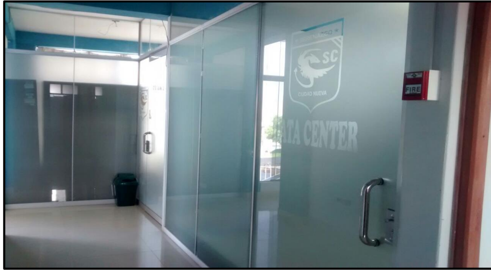
ACONDICIONAMIENTO DEL DATA CENTER DONDE SERÁN INSTADOS LOS EQUIPOS TECNOLÓGICOS PARA EL CENTRO DE MONITOREO.
